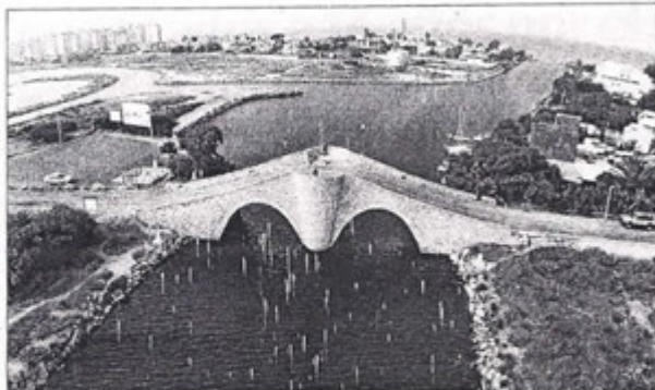
El puente de Venecia o 'puente de la risa', que será reparado. JOSÉ LUIS CANAVEJA
